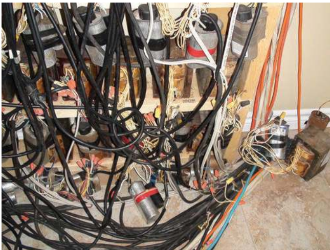
Grow Op Wiring
